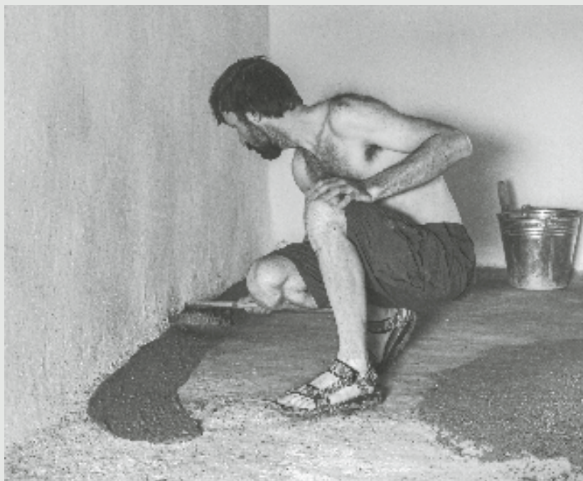
Workshop Použití hlíny ve venkovském stavitelství – údržba hliněné podlahy. Foto: Martin Novotný, 2017. Z archivu NÚLK
